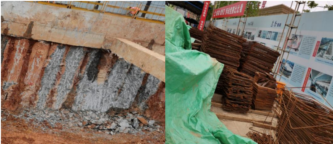
维护墙及桩部分区域的内置钢筋裸露
